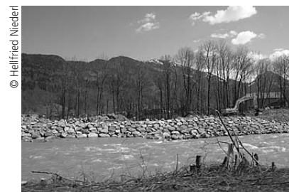
© Hellfried Niederl Neue Verbauung an der Bregenzerach/A, knapp unterhalb des Gewerbe- gebiets.
